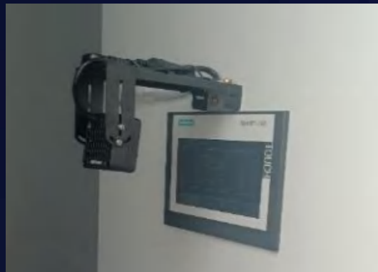
企业、建筑大楼配电柜仪表
