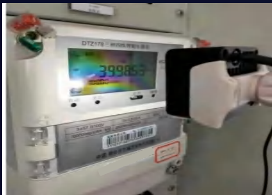
企业、建筑大楼电表
