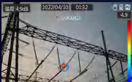
电网、企业变电站接头放电检测
