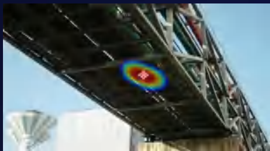
工厂、管廊管道气体泄漏检测
